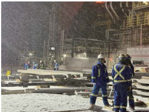
△ 加拿大子公司的 Overhead Corrosion、Chemical Tank T17T58 等多个项目仍在运行，有 75 人左右坚守在施工现场。图为一线员工在零下 30 度大雪纷飞的项目现场进行 Overhead Corrosion 项目现场组装主结构支撑作业
